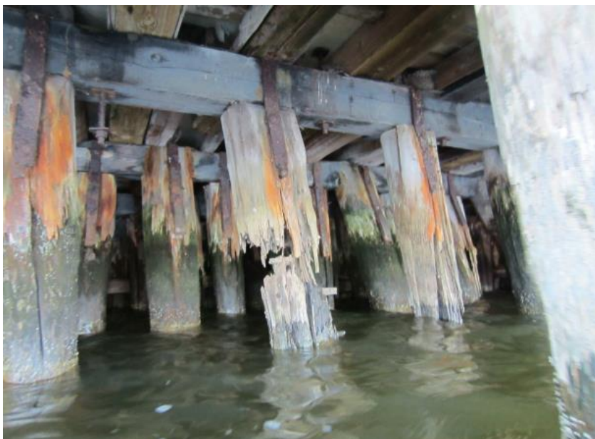
Figur 5-7 - Exempel på pålar vars tekniska livslängd är uppnådd vid kajen. (Marcon 2013)
